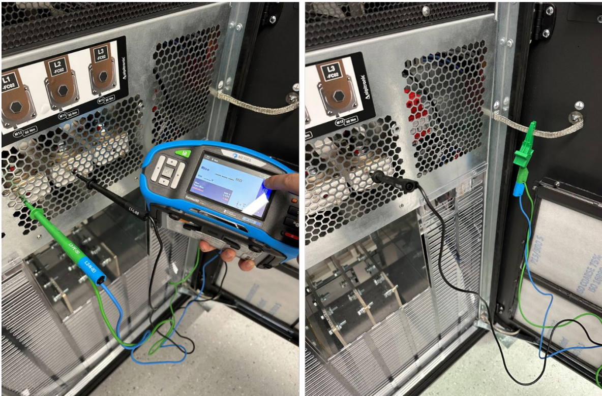
Abbildung 114: Power Cabinet Isolationsprüfung - Sicherungen
