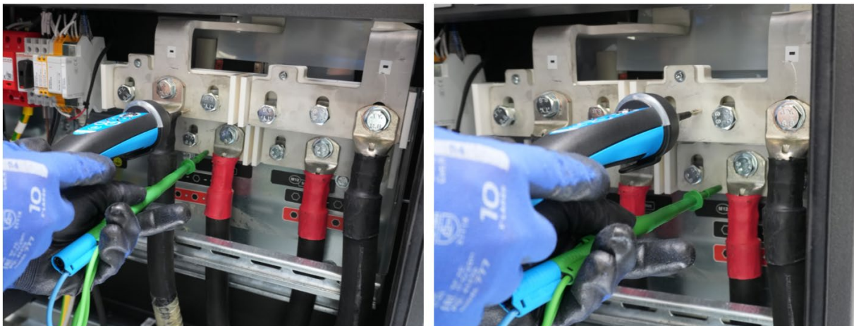
Abbildung 109: Isolationswiderstand DC+ / DC- am EV-Dispenser
