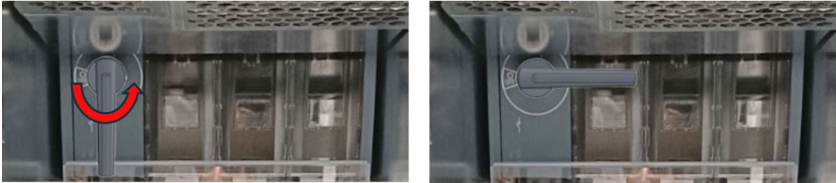
Abbildung 121: Hauptschalter in Off-Position
