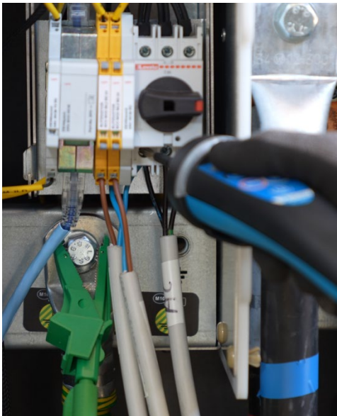
Abbildung 115: Isolationswiderstandsprüfung an den Dispensern
