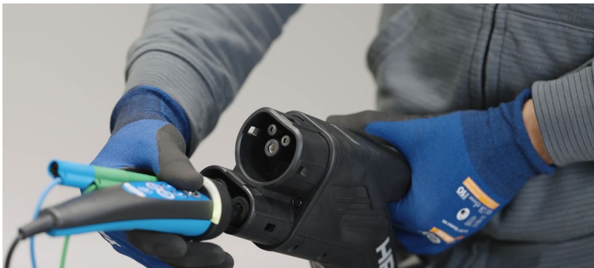
Abbildung 111: Isolationsmessung Ladekabel: DC+ gegen DC-
